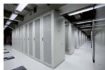
顧客企業のサーバーを設置する 専用ラック群
